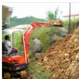
Préparation d'un talus qui s'est affaissé suite à de fortes averses de pluie
