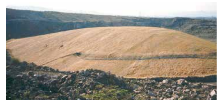
Covamat plus venant juste d'être installé sur une décharge pour assurer une protection temporaire contre l'érosion
