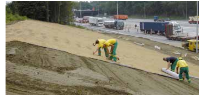
Environ 60.000 m 2 de Covamat fresh ont été installés sur le périphérique d'Anvers, en Belgique.
