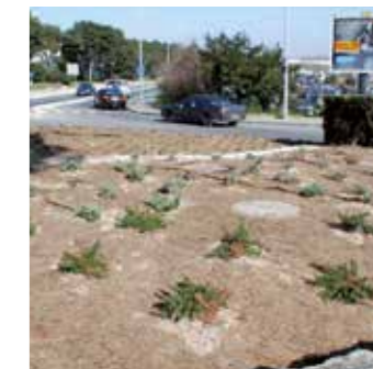
Paillage de protection des plantes avec la natte Mulchmat f³ GREENFIX, sur un rond-point situé dans le sud de la France
