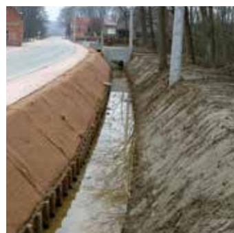
Protection de talus le long d'une tranchée à ciel ouvert avec la natte Eromat GREEN-FIX
