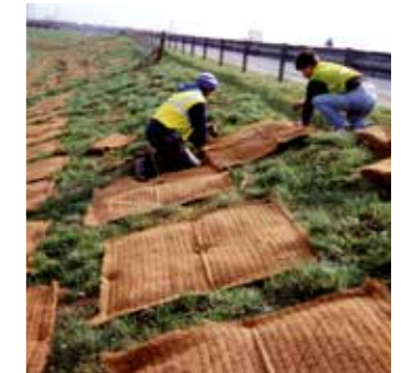
Contournement de Norwich, en Angleterre : protection de plants individuels au moyen de carrés de Mulchmat GREENFIX préfabriqués.
